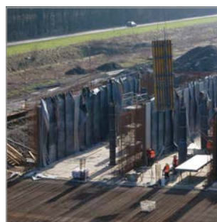
Water Treatment Plant, Essen (D), 2011
